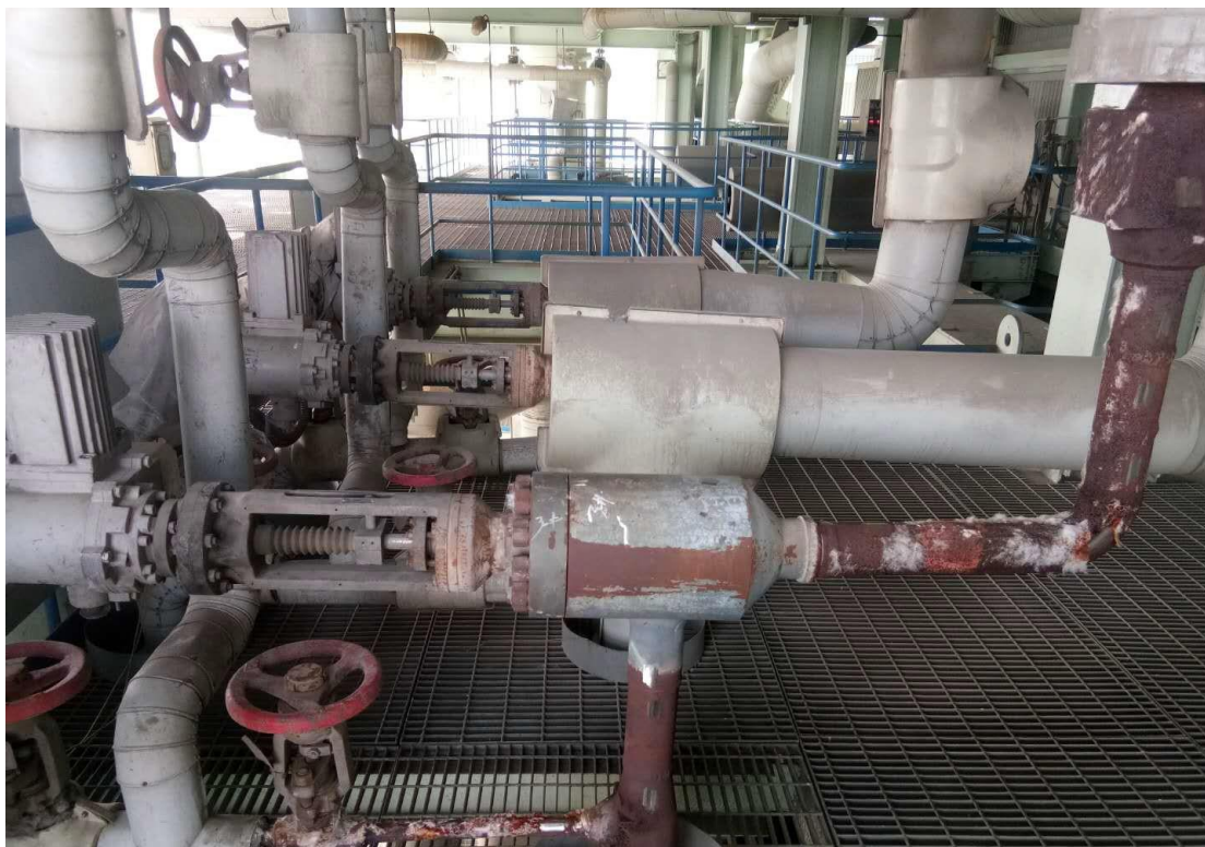
图 48 国华徐州电厂 2X1000MW 超超临界机组原进口过热器减温水调节阀 (P=38MPa)
