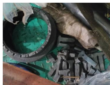
图 18 华能福州电厂 高压旁路阀阀笼全部碎了
