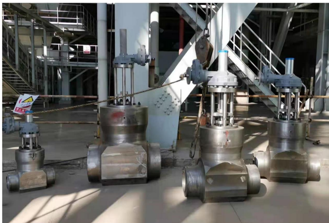
图 46 沙洲电厂 2X1000MW 超超临界机组主给水和主给水旁路电动闸阀（ P=39\text{MPa} ）以及 2X630MW 超临界机组憋压阀（阀体材料：WB36；）
