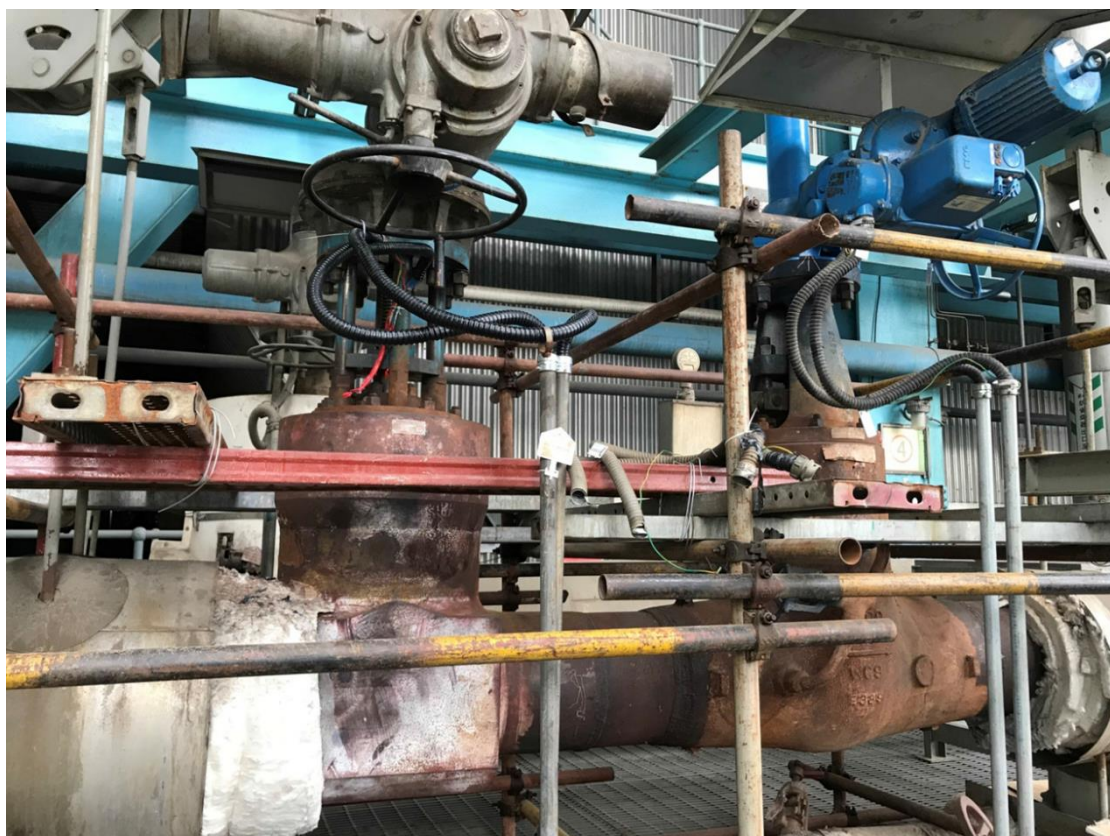
图 45 2016 年 12 月，为华能井冈山电厂 6 号机组设计制造的用于 361 阀后的电动整体锻造闸阀（左侧，阀体材料：12Cr1MoV）；右侧是进口铸钢闸阀（闸阀底部出现外漏）
