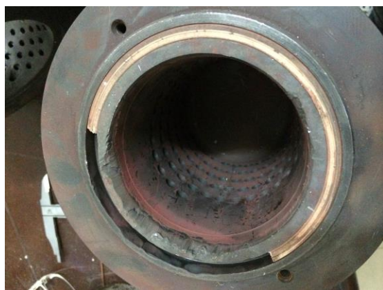
CV 阀座损坏情况
