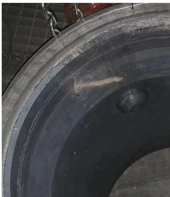
图 27 华能莱芜电厂#6 号机组高压旁路阀减温器已使用两年半的情况，整个减温器完好。
