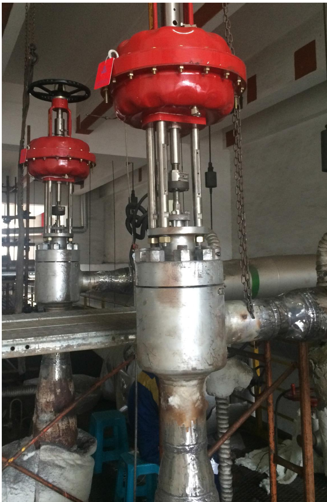
华电可门电厂 600MW 超临界机组给水再循环最小流量调节阀 (原阀门是 CCI 产品)
