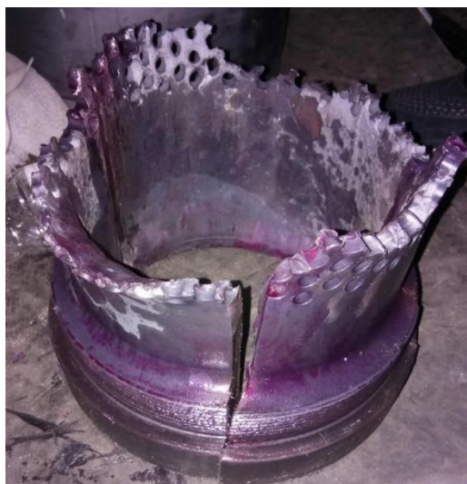
图 22 华能莱芜电厂#6 号机组 高压旁路阀阀座损坏情况
