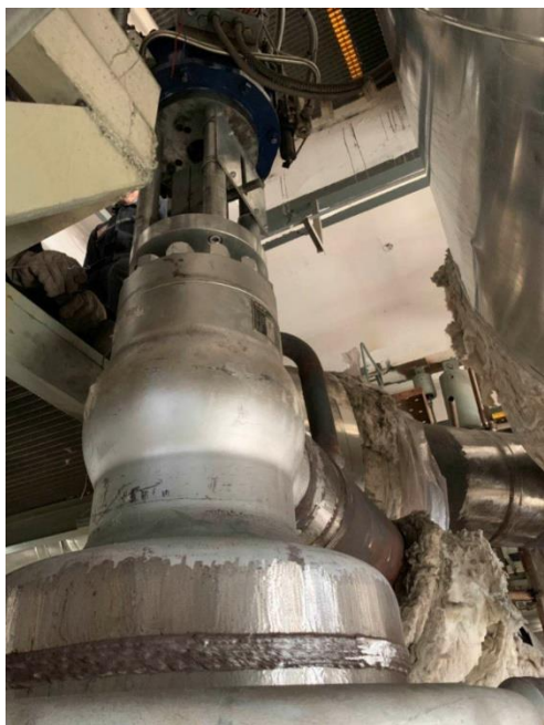
图 1 制造商设计制造的高压旁路阀（材料 F91）同煤集团同达电厂（330MW 机组 2019 年 5 月）
