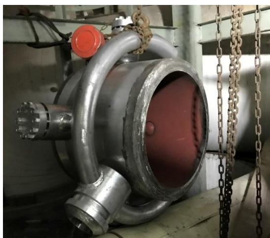
图 25 华能莱芜电厂#6 号机组 高压旁路阀改造后的减温器
