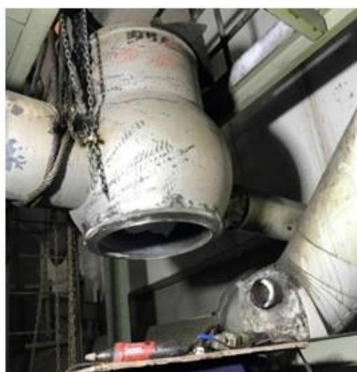
图 23 高压旁路阀减温器切除
