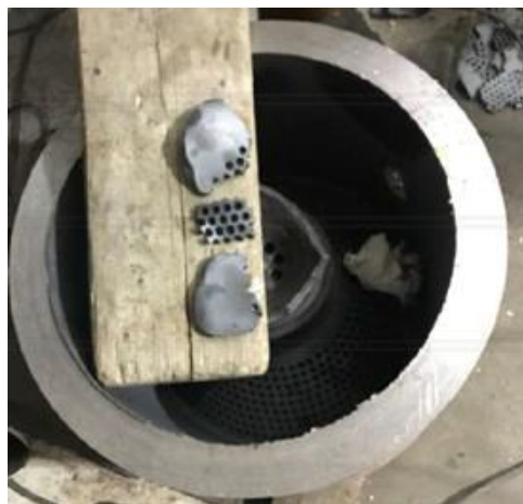
图 21 华能莱芜电厂#6 号机组 高压旁路阀阀座节流套损坏
